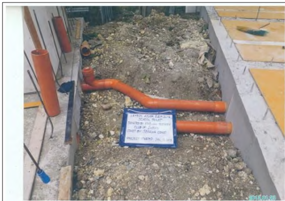
浄化槽とトイレ建屋との配管
